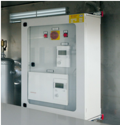
Quadro di comando con telecomando e manager di cascata
