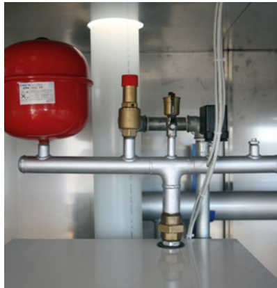
Collettore con vaso di espansione e sistema fumi
