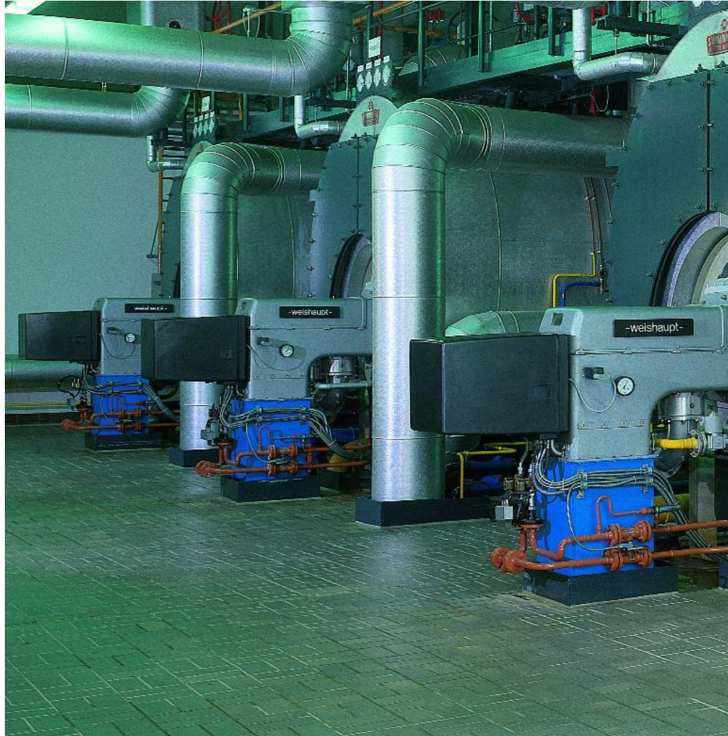
Centrale di teleriscaldamento con bruciatori misti Weishaupt WKGL50 e WKGL3 – potenzialità comp. 28 MW
