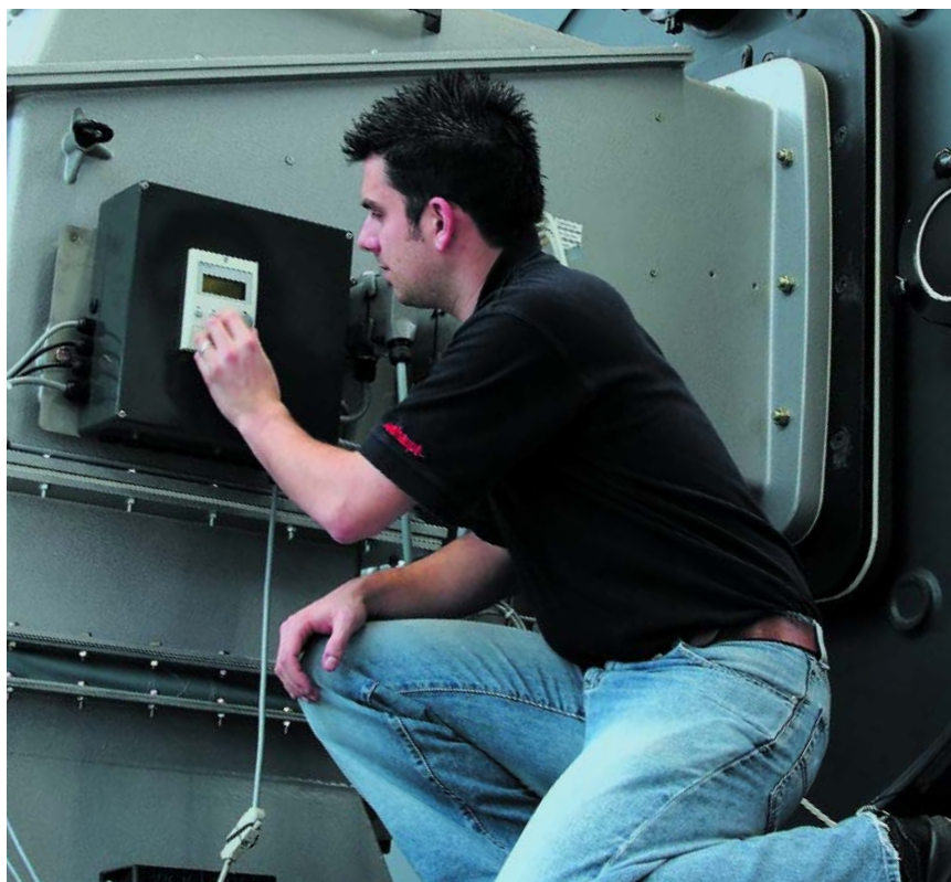
Entrée des données et contrôle par le module de commande et d'affichage
